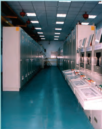
原料計量 Dosing equipment
