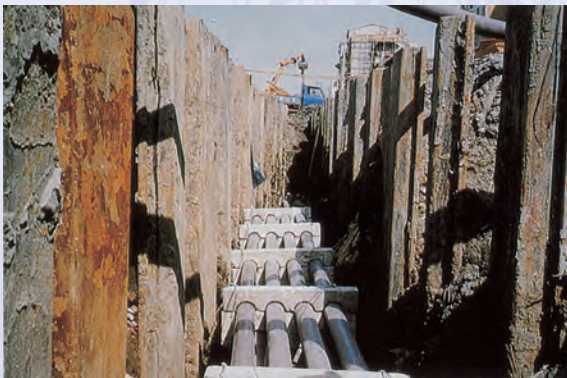
▲ 電氣工程 Electrical engineering
